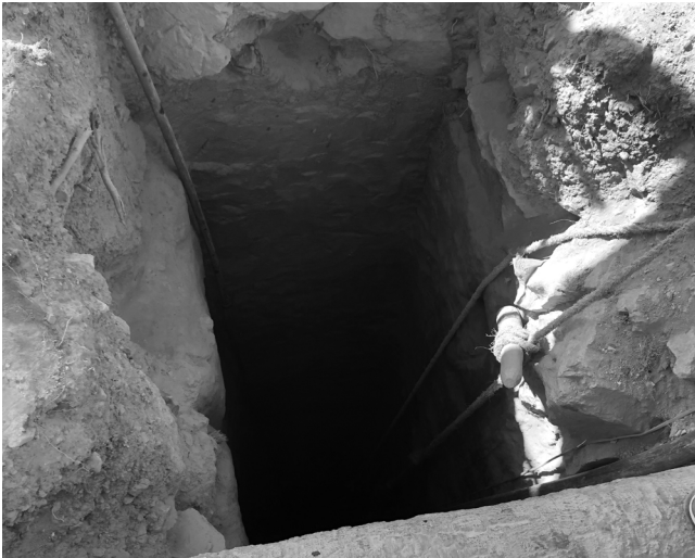
Figura 14: Poço de mineração com paredes inseguras
